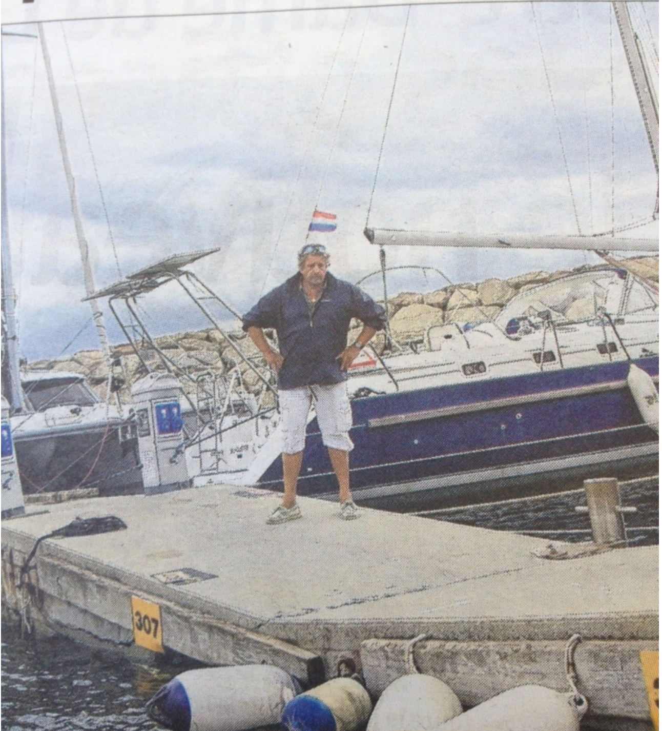
Le directeur du port découvrant, fin 2016, l'effondrement de la travée « n° 9 » du ponton DC du port de Toga.
